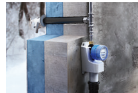
Leitungen, die nur zu bestimmten Zeiträumen im Jahr genutzt werden
